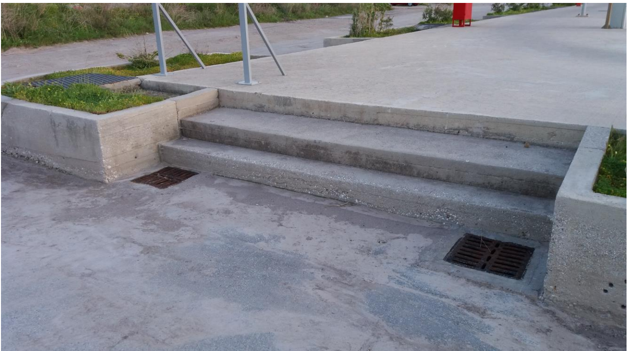
Φωτ. 2 Τα υφιστάμενα φρεάτια απορροής ομβρίων
