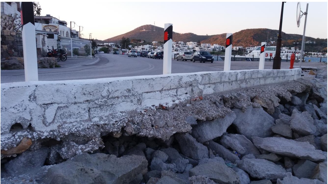
Φωτ. 4 Η υποχώρηση των φυσικών ογκολίθων της θωράκισης, έχει ως αποτέλεσμα το παζοδρόμιο και το άκρο της παραλιακής οδού να είναι στο κενό.
