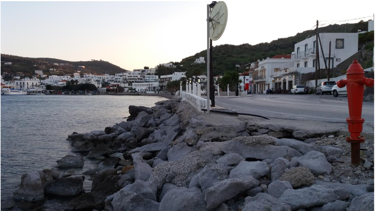
Φωτ. 3 Άποψη της παραλιακής οδού του οικισμού Σκάλας Πάτμου. Διακρίνεται ότι έχει κατασκευασθεί επί θωράκισης από φυσικούς ογκολίθους, οι οποίοι έχουν υποχωρήσει.
