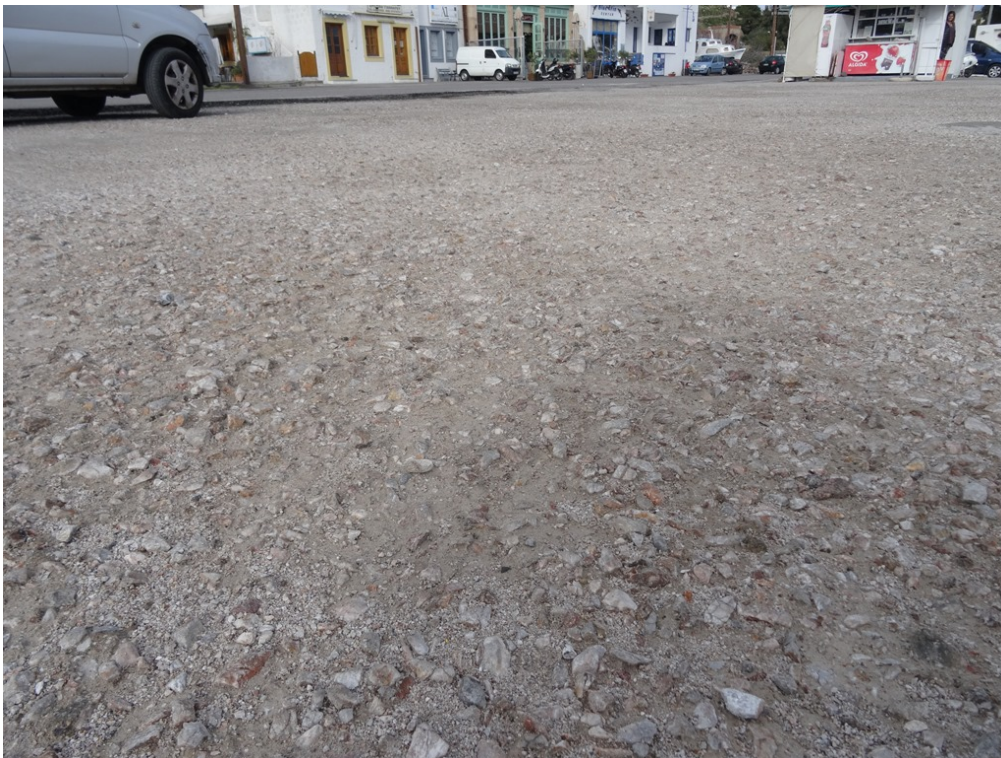
Φωτ. 2 Λεπτομέρεια της επιφάνειας της επίστρωσης από σκυρόδεμα. Διακρίνεται η αποσάθρωση και τα αδρανή υλικά που προεξέχουν.
