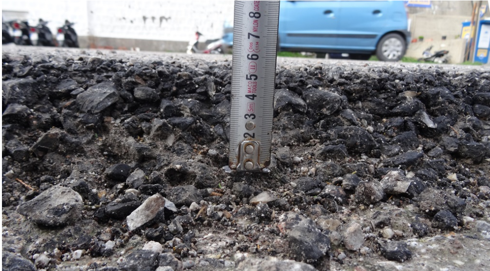
Φωτ. 3 Λεπτομέρεια του άκρου του ασφαλτοτάπητα της παραλιακής οδού. Διακρίνεται η υψομετρική διαφορά περίπου 5cm που υπάρχει με την επίστρωση του κρηπιδώματος.
