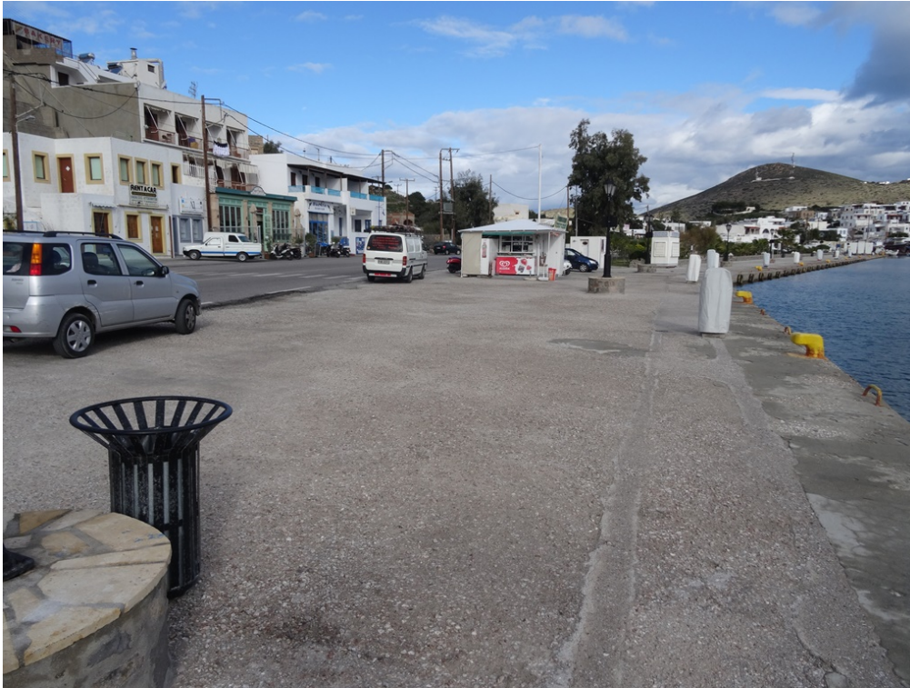
Φωτ. 1 Άποψη του παραλιακού κρηπιδώματος (παλιάς μαρίνας) του λιμένα Σκάλας Πάτμου. Διακρίνεται η αποσαθρωμένη επιφάνεια του σκυροδέματος της επίστρωσης, καθώς και ο εξοπλισμός της (ιστοί φωτισμού, pillars, δέστρες και κρίκοι πρόσδεσης).
