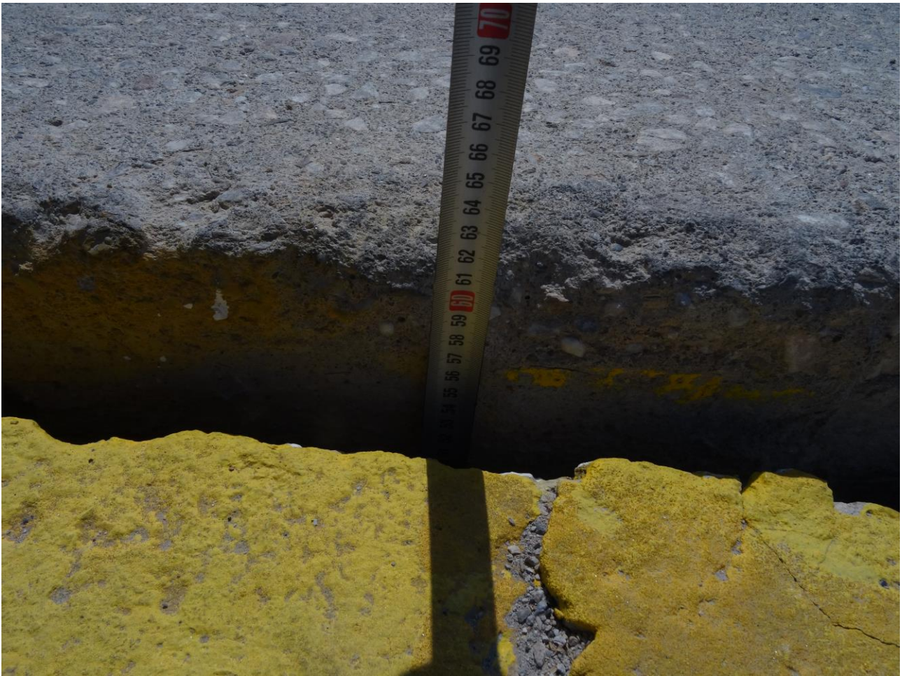
Φωτ. 2 Λεπτομέρεια του αρμού μεταξύ κρηπιδοτοίχου και επίστρωσης ανακουφιστικού επιχώματος από σκυρόδεμα. Θεωρώντας ότι η επίστρωση έχει πάχος 15cm, προκύπτει ότι το επίχωμα έχει υποστεί καθίζηση περίπου 40cm. Παράλληλα έχει δημιουργηθεί ανισοσταθμία της τάξης των 10cm.
