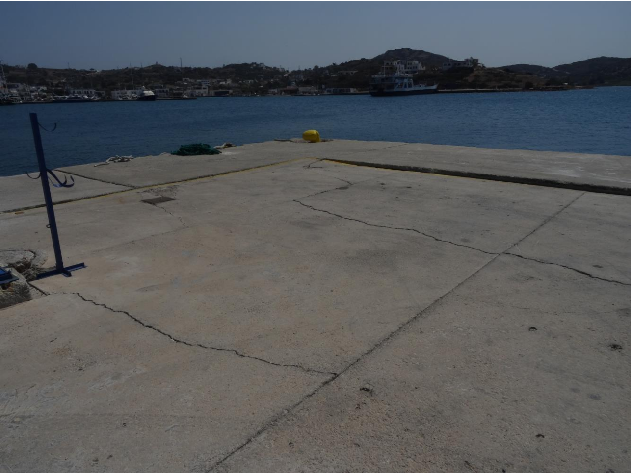
Φωτ. 1 Άποψη του Νοτιοανατολικού τμήματος του προβλήτα Ε/Γ-Ο/Γ σκαφών λιμένα Λειψών. Η καθίζηση της επίστρωσης του ανακουφιστικού επιχώματος είναι εμφανής, με την ύπαρξη ανισοσταθμίας με τον κρηπιδότοιχο και επιμήκων ρηγματώσεων σε διάφορα σημεία.
