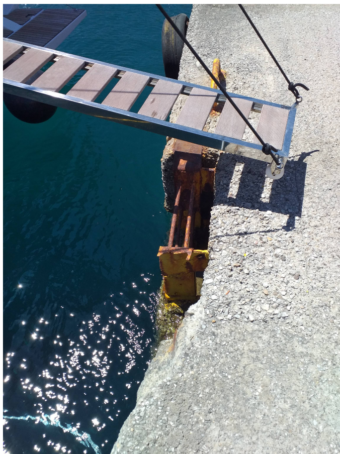
Φωτ. 5 Σκάλα ασφαλείας που έχει οξειδωθεί και χρήζει απομάκρυνσης λόγω επικινδυνότητας.
