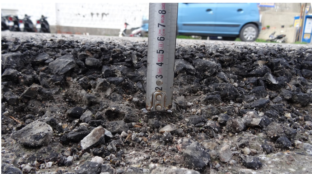
Φωτ. 4 Λεπτομέρεια του άκρου του ασφαλτοτάπητα της παραλιακής οδού. Διακρίνεται η υψομετρική διαφορά περίπου 6cm που υπάρχει με την υφιστάμενη αποσαθρωμένη επίστρωση του κρηπιδώματος.
